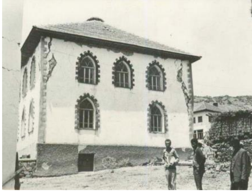
Şekil 2.9. Esnek kat döşemeli yığma yapıda deprem hasarı [33]
