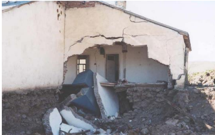
Şekil 2.6. 2003 Bingöl Depremi'nde yığma bir yapının oturma kaynaklı göçmesi [31]
