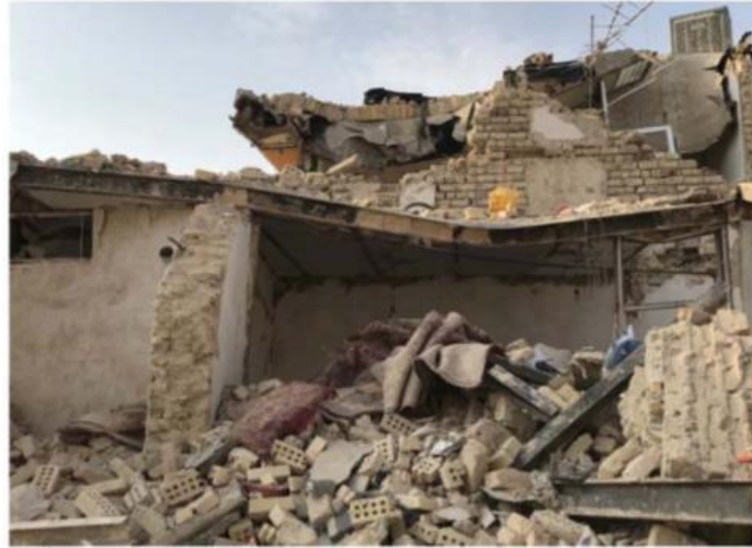
Şekil 1.5. İran Depremi'nde gözlemlenen yığma yapı hasarı [12]
