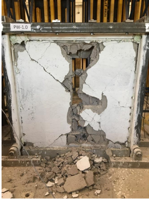
Şekil 4.32. PW-1.0 dolgu duvarının deney sonu görüntüsü
