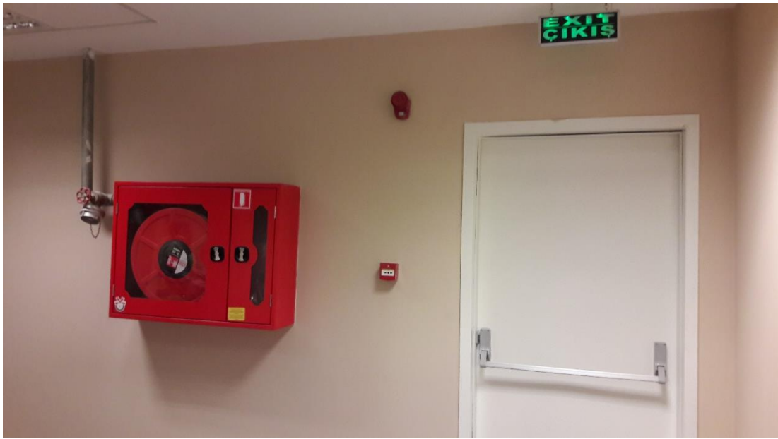
Şekil 5.6. Spor Tesisi Yangın Dolabı
