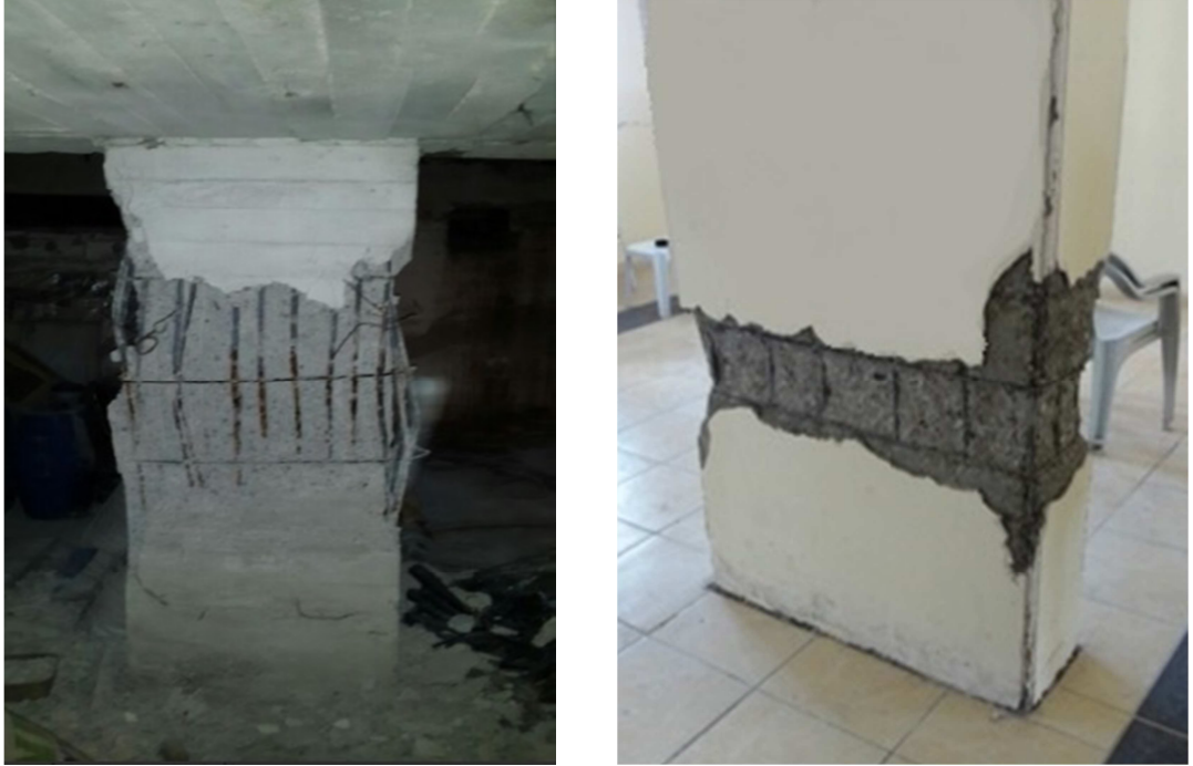
Şekil 1.2. Hasarlı kolon örnekleri
