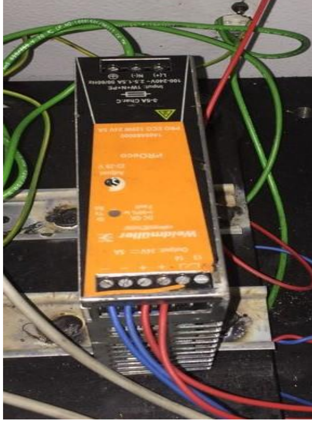
Şekil 4.5. Projede kullanılan güç kaynağı
