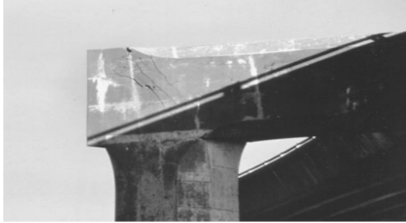
Şekil 2.12. 1989 Loma Prieta depreminde kiriş hasarı
