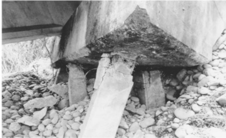
Şekil 2.18. 1991 Kosta Rika depremi sırasında köprü kazıklarının hasar görmesi [39]
