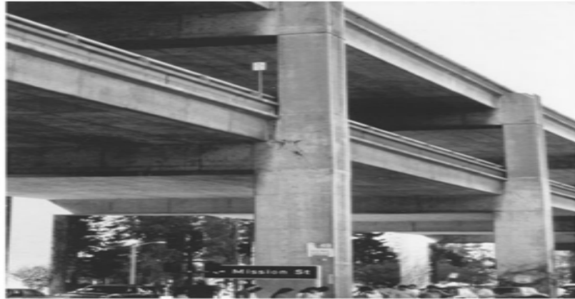
Şekil 2.13. 1989 Loma Prieta depreminde Embarcadero viyadüğün hasarı
