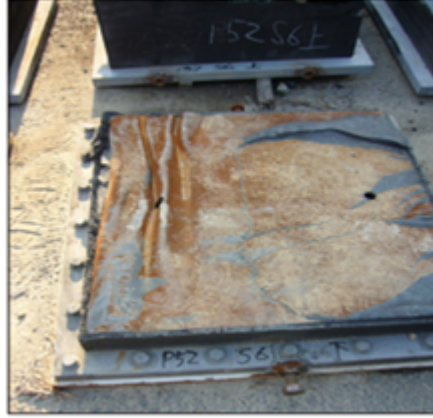
Şekil 2.23. Elastomerik mesnet hasarı, Sendai-Tobu viyadüğü
