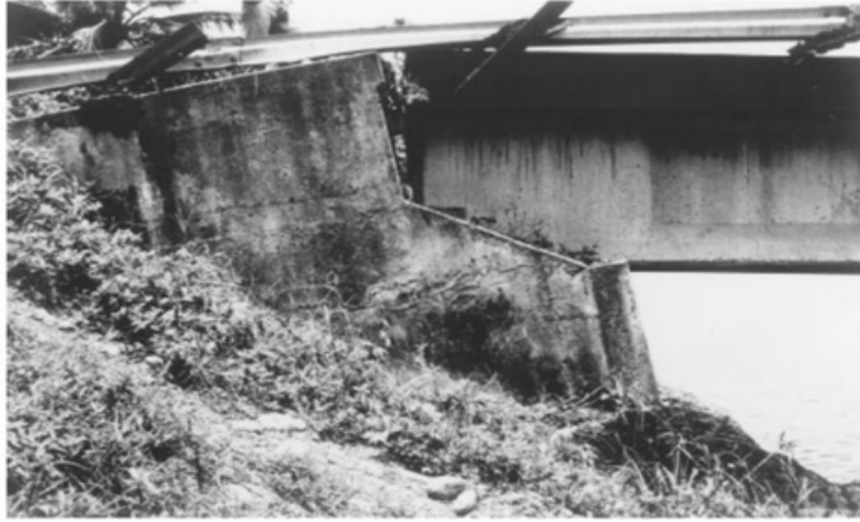
Şekil 2.17. 1991 Kosta Rika depremi sırasında sıvılaşma ve yanıl yayılma nedeniyle köprü [38]
