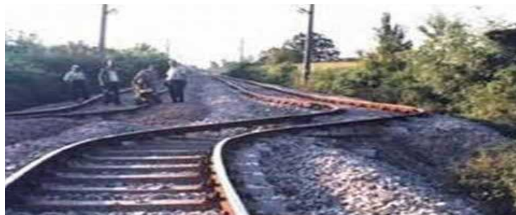
Şekil 2.4. 1999 Kocaeli depreminde kullanılamaz hale gelen demiryolu hattı
