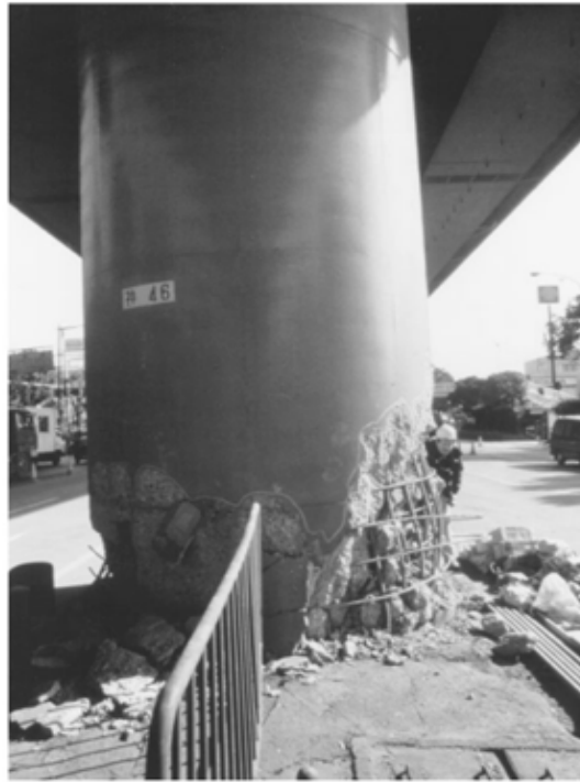
Şekil 2.8. 1995 Kobe depreminde Hanshin otoyolu köprü ayağı hasarı
