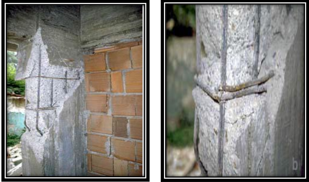
Şekil 1.2. 1999 Marmara depreminde hasarlı kolon [1]
