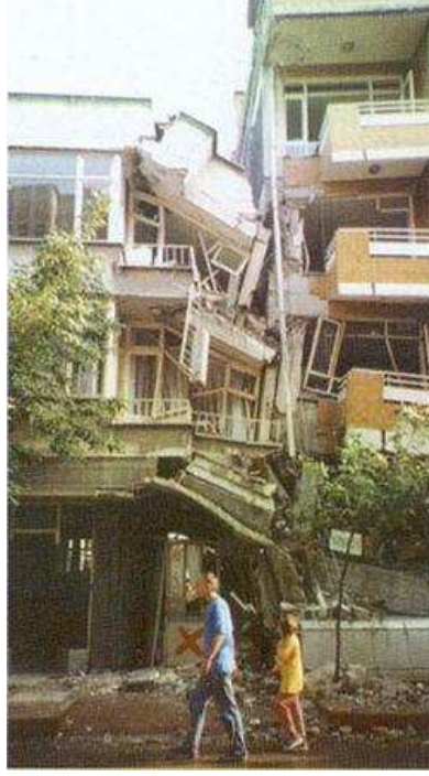
Şekil 22 : Bina Yoğunluğunun Hasara Etkisi
