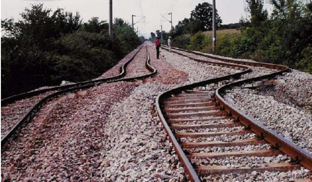
Şekil 2.9. Marmara depreminden meydana gelen kalıcı yer değiştirme [41]
