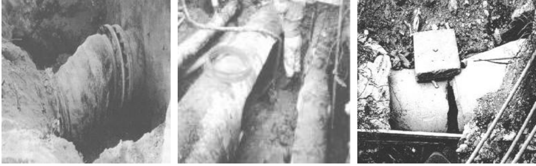
Şekil 2.5. Adapazarı su ve atık su hattında borularda karşılaşılan hasarlar [23]
