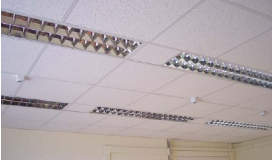
Şekil 3.2. Armatürler ve kontrol sistemi ışık algılayıcılarının tavana yerleşimi
