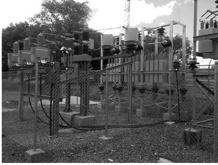
Şekil 3.12. Dağıtım trafo merkezindeki kondansatör bankaları [87].
