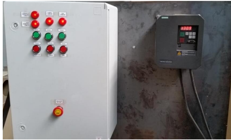
Şekil 3.29. Hava hızı kontrolü için frekans konvertörü kullanımı (1309 rpm devirde çalışırken)
