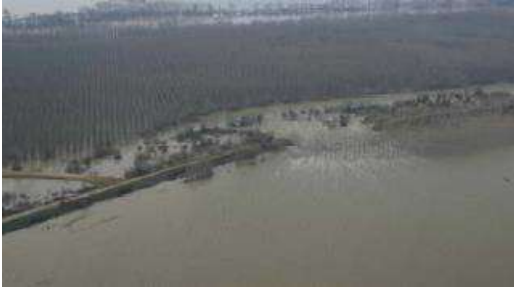
Şekil 5.45. 2006 taşkınında sedde yargını [63].
