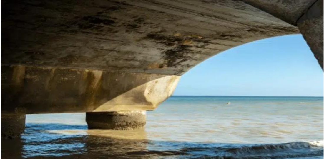
Şekil 2.3. Betonun sülfat etkisi sonrası görünümü (Ustabaş, 2008).
