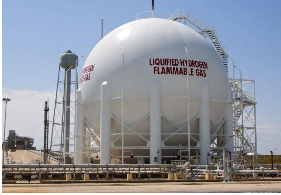
Şekil 1.14. Sıvı hidrojen tankı [57].
