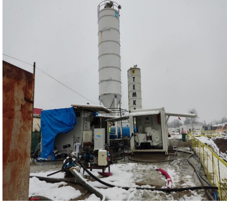
Şekil 3.10. Santral ve pompa ünitesi.
