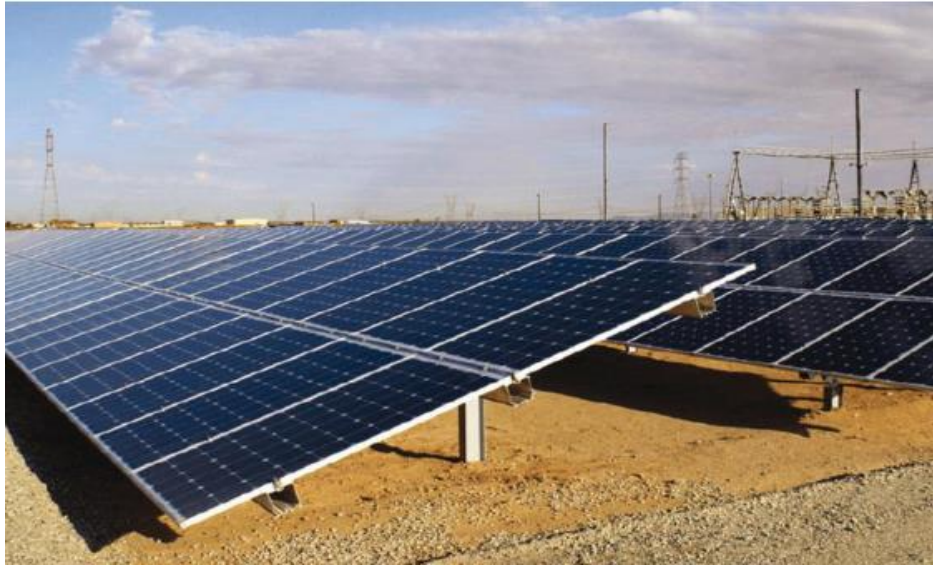
Şekil 2.2. Elektrik enerjisi santralinde fotovoltaik panellerin yerleşimi [34].
