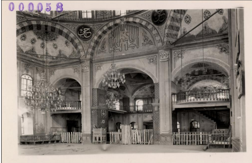
Fotoğraf 31: 1944 Yılında Meydana Gelen Depremde Yapının İçinden Görünümü, İç Mekânda Deprem Sonrası Önlem Alınmış
