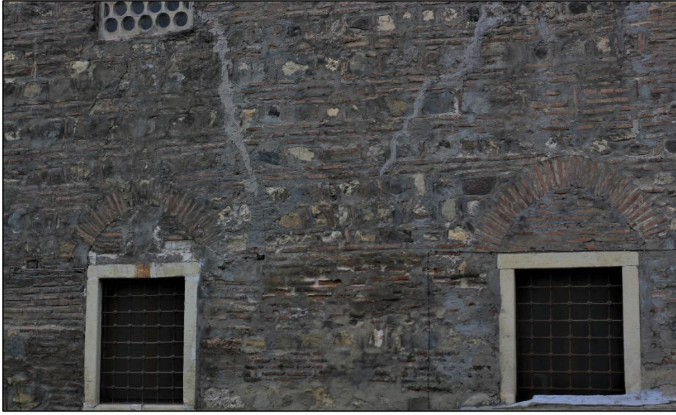
Fotoğraf 123: Doğu Cephesi Örgü Sisteminin Deformasyonu
