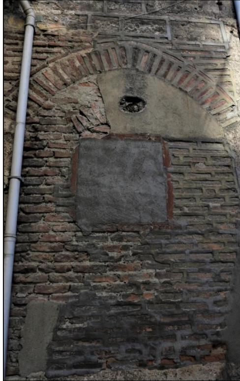
Fotoğraf 146: Doğu Cephedeki Duvar Örgüsünün ve Açıklıkların Deformasyonu
