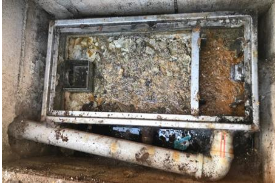
Şekil 4.2. Konut dışında gri suyun biriktiği yağ tutucu ünitesi
