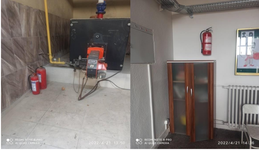
Şekil 4.20. Yangın söndürücülerin yanlış konumlandırılması.
