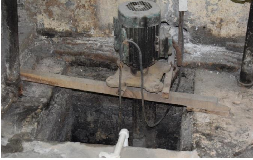
Şekil 4.16. Kazan dairesi içindeki pis su çukurunun üzerinin açık olması.
