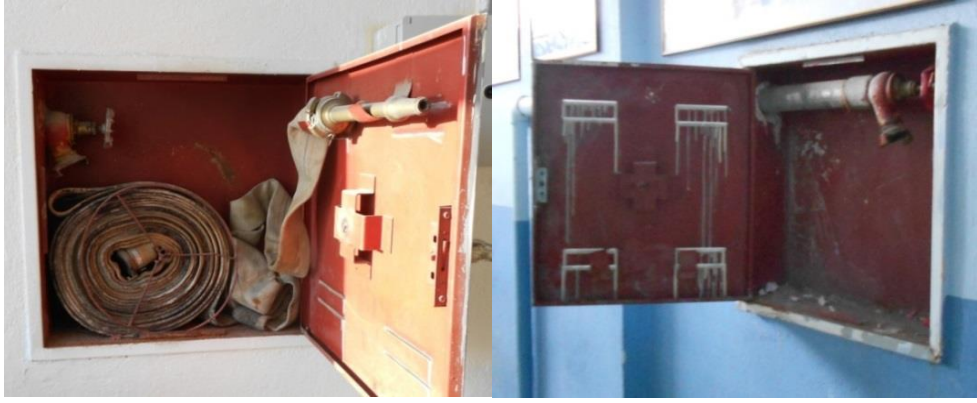
Şekil 4.14. C,D ve E bloklarındaki yangın dolapları ve tesisatları çalışmamaktadır.
