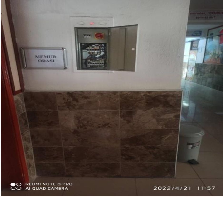
Şekil 4.31. Elektrik pano kapaklarının açık olması.
