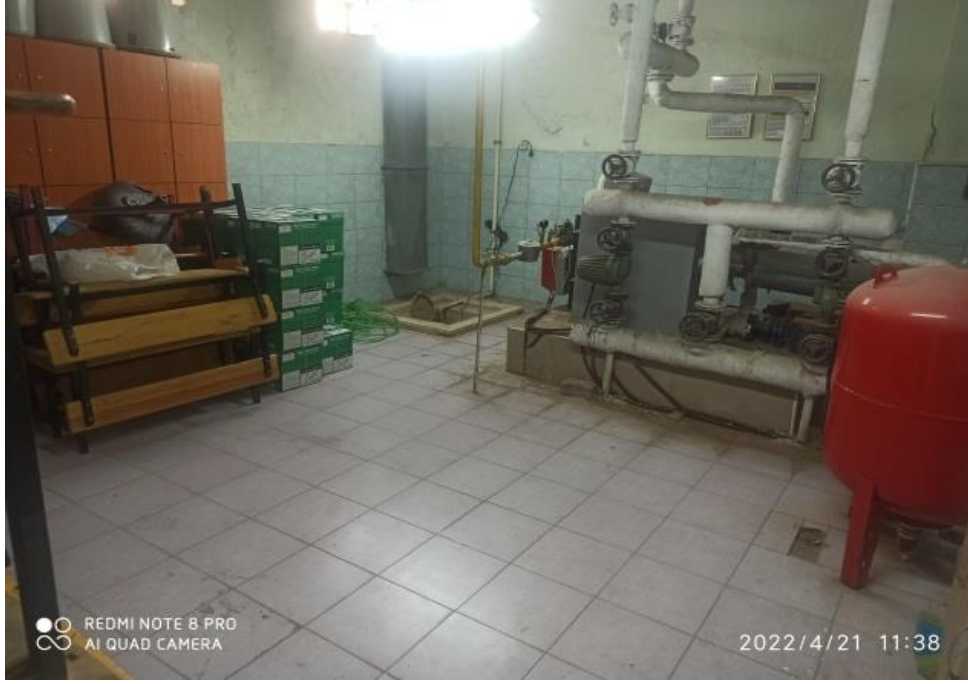
Şekil 4.29. Kazan dairesi çevresinde yanıcı malzemelerin olması.
