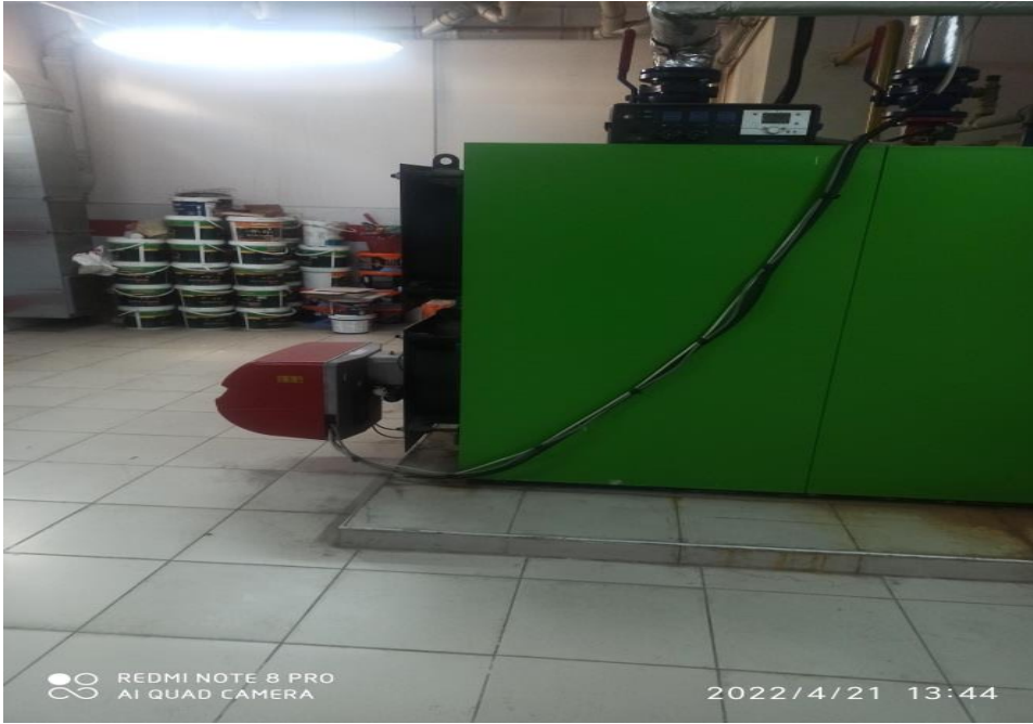
Şekil 4.17. Kazan dairesi çevresinde yanıcı malzemelerin konulması.
