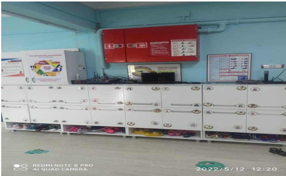
Şekil 4.37. Yangın dolabına ulaşımın engellenmesi ve yanlış konumlandırılması.
