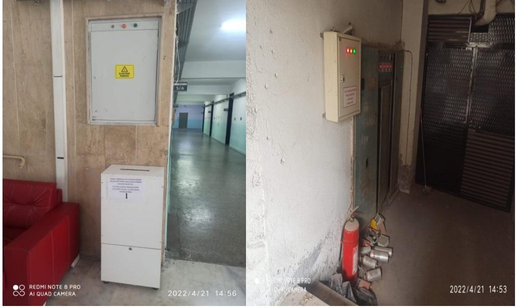
Şekil 4.22. Elektrik panolarını önünde kauçuk paspas olmaması.
