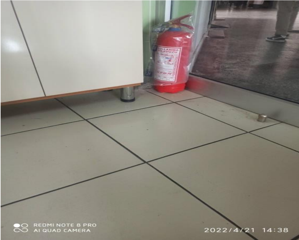
Şekil 4.6. Yangın tüpünün yanlış konumlandırılması.
