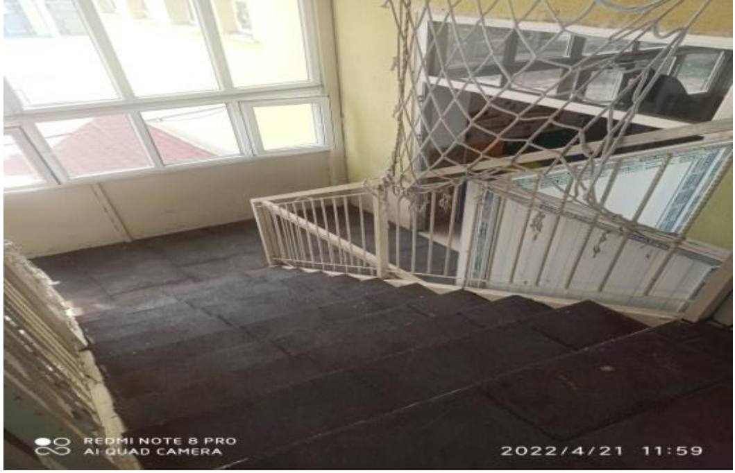
Şekil 4.33. Yangın merdivenlerinin normal çıkış merdiveni olarak kullanılması.
