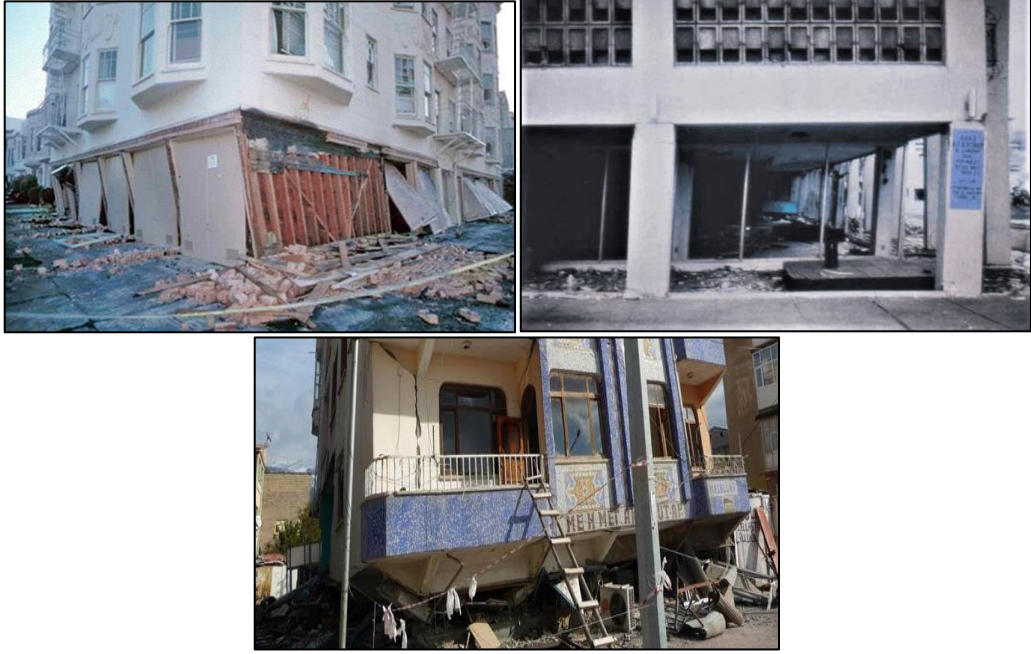
Şekil 2.5. Yumuşak kat düzensizliği sonucu yıkılan binalar
