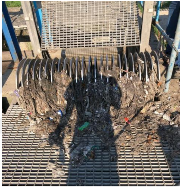
Şekil 1.3. Manuel temizlemeli kaba ızgara kullanan bir tesisin gelen atıklar nedeniyle tıkanan kaba ızgarası.
