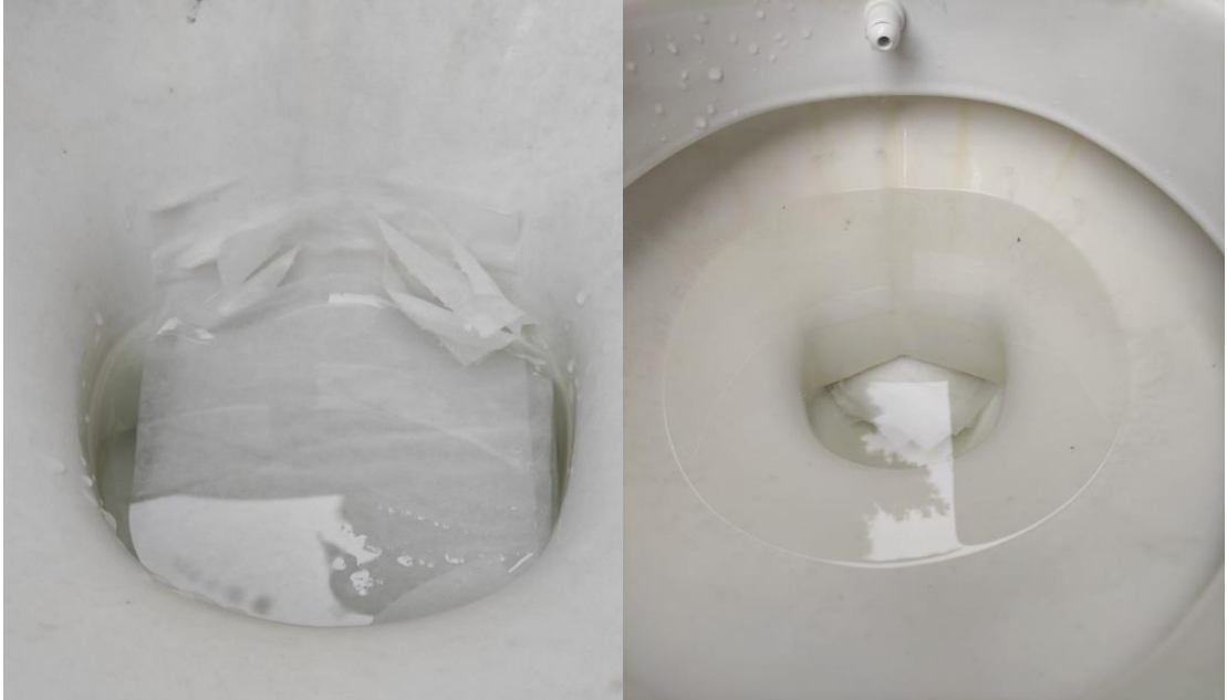
Şekil 3.2. Tuvalete atılan tuvalet kağıdı yaprakları (solda) ve tıkanan tuvalet gideri (sağda)
