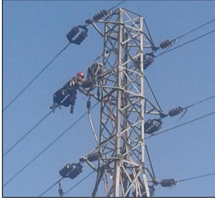
Şekil 2.28. İletkenlerin izolatörlere bağlanması
