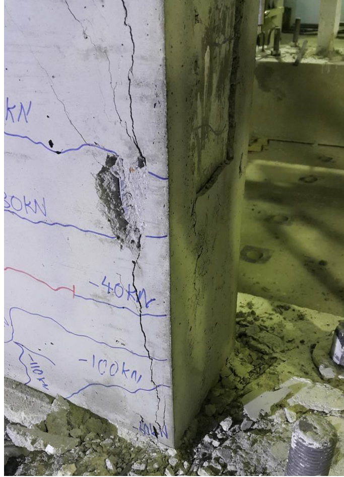
Şekil 6.24. Deney sonucunda düşey donatılara paralel çatlak oluşumu
