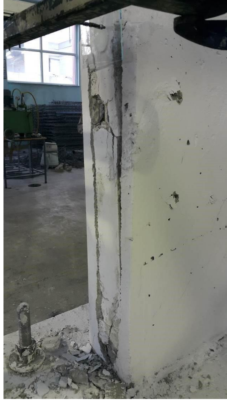
Şekil 6.30. Onarım mantolarının çekirdekten ayrılması
