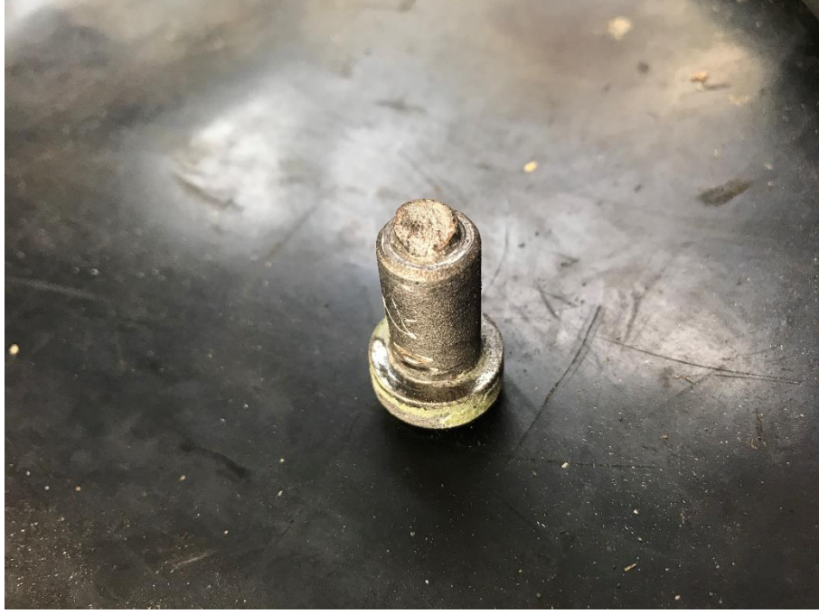
Şekil 1.2. Dinamik hasara uğramış bir bağlantı elemanı
