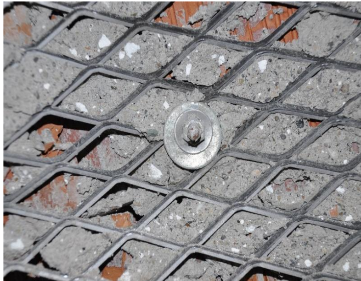
Şekil 4.13. MBW 3,0-150 elemanın deney sonu hasar durumu
