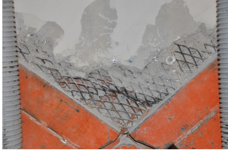
Şekil 4.16. MBW 3,0-200 deney sonu hasar durumu
