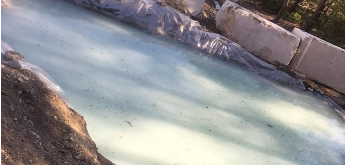
Şekil 4.11. Mermer ocağında plastik branda ile sızdırmazlığı sağlanmış çöktürme havuzu
