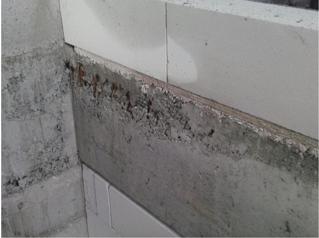
Şekil 4.20. Kirişlerde net beton örtüsü şartına uyulmaması durumu
