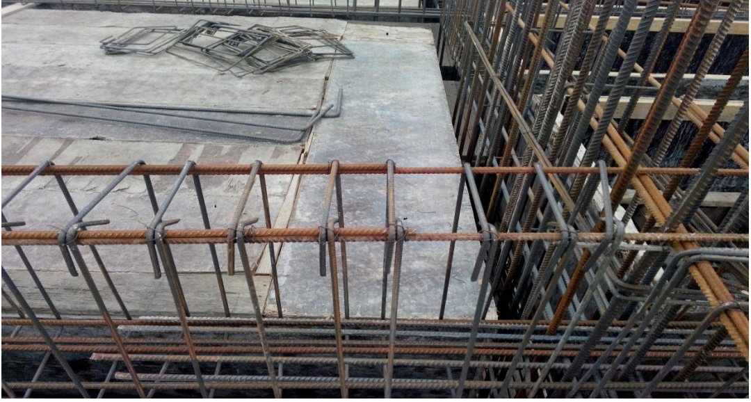
Şekil 4.4. Etriye kancalarının 135 derece olmaması durumu
