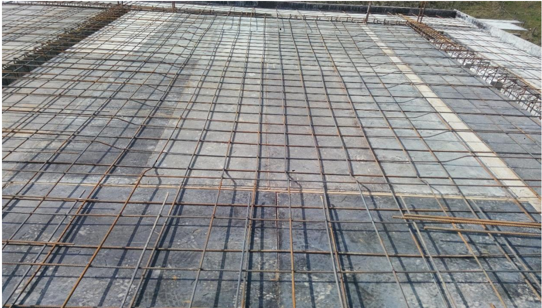
Şekil 4.25. Kirişli plak döşemelerde net beton örtüsüne uyulmaması durumu
