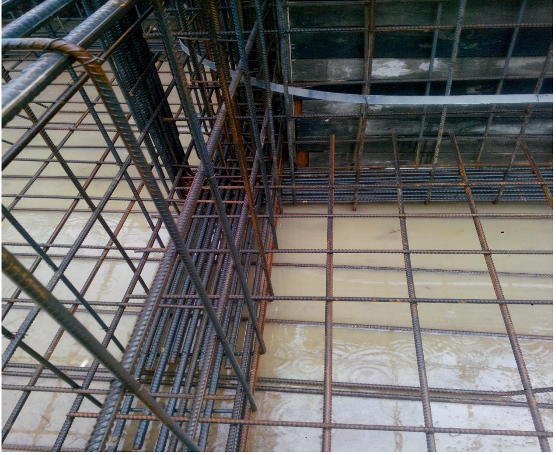
Şekil 4.33. Temel kirişlerinde boyuna donatılar arası mesafe şartına uyulmaması durumu
