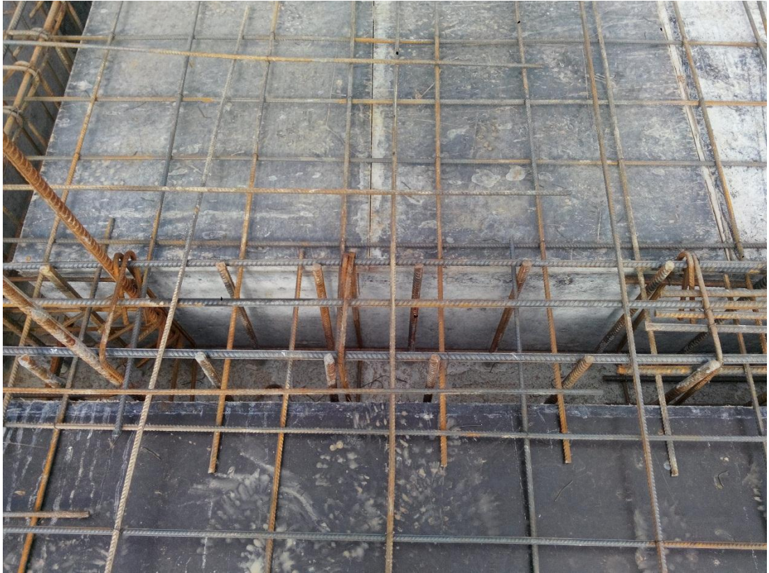
Şekil 4.21. Kolon-kiriş birleşim bölgesinde enine donatı şartına uyulmaması durumu
