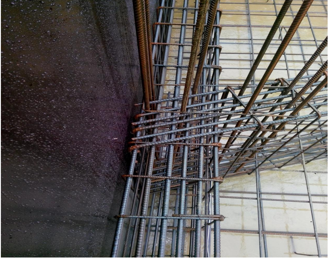
Şekil 4.34. Temel kirişlerinde boyuna donatıların kenar kolonların içine 90 derece kıvrılmasına uyulmaması durumu
