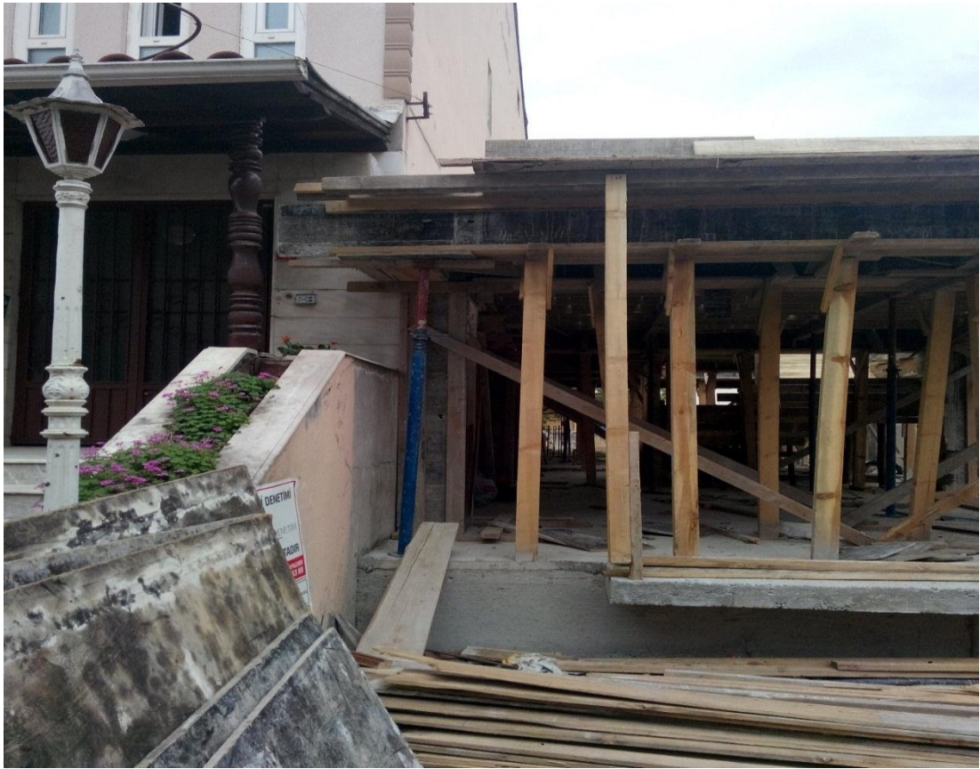
Şekil 4.7. Bitişik nizam yapılan binanın derz koşuluna uymaması durumu
