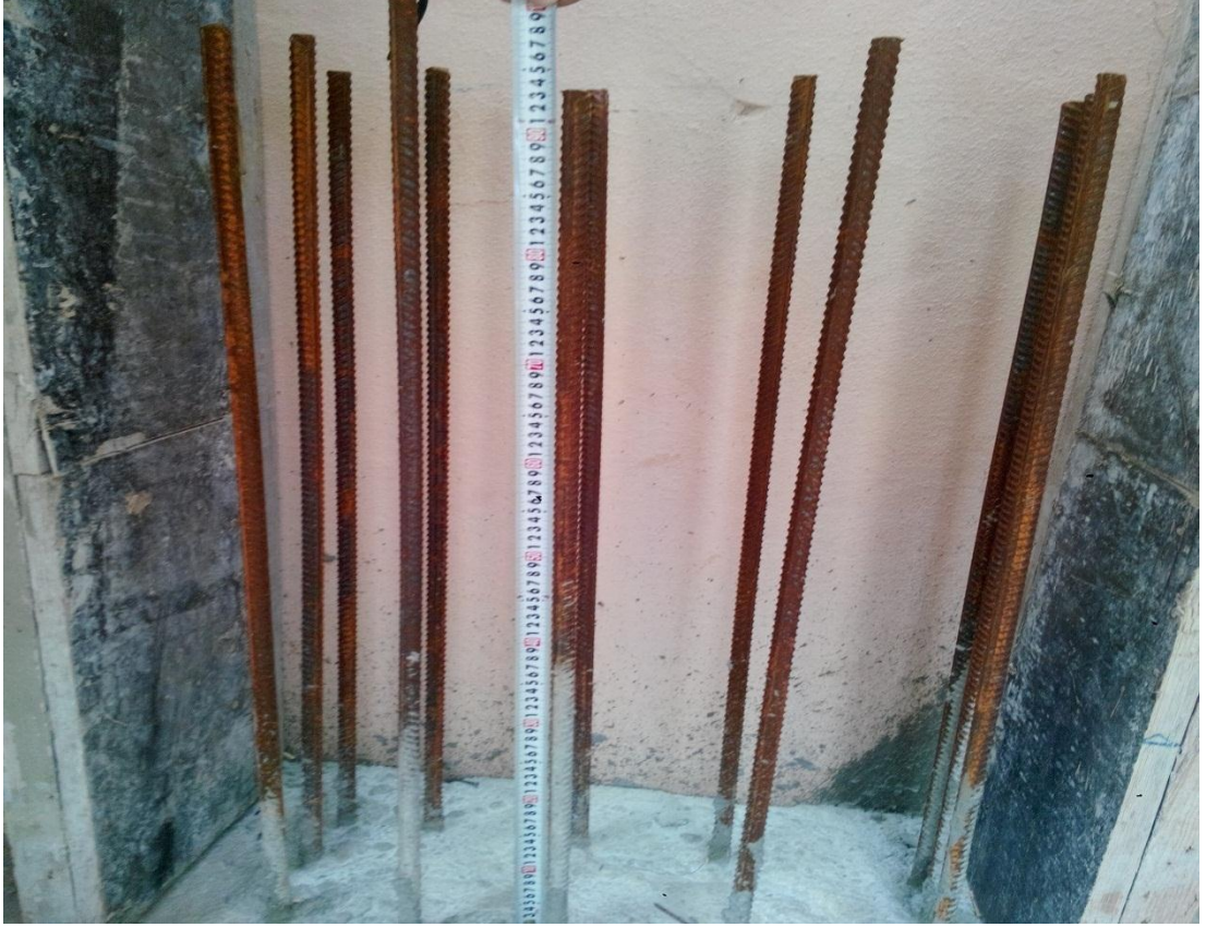
Şekil 4.12. Bindirme boyu uygunsuz kolon filizleri örneği
