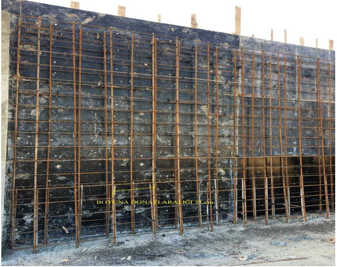
Şekil 4.28. Düşey donatı aralığı şartına uyulmaması durumu
