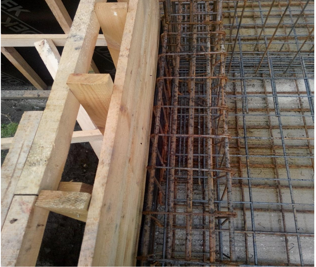
Şekil 4.37. Kirişli radye temelerde net beton örtüsü şartına uyulmaması durumu
