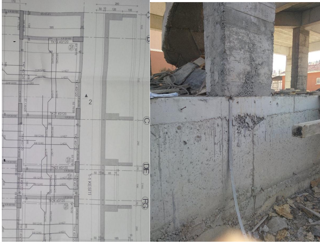
Şekil 4.39. Projesine uygun imal edilmeyen su basman perdesi-kolon örneği
