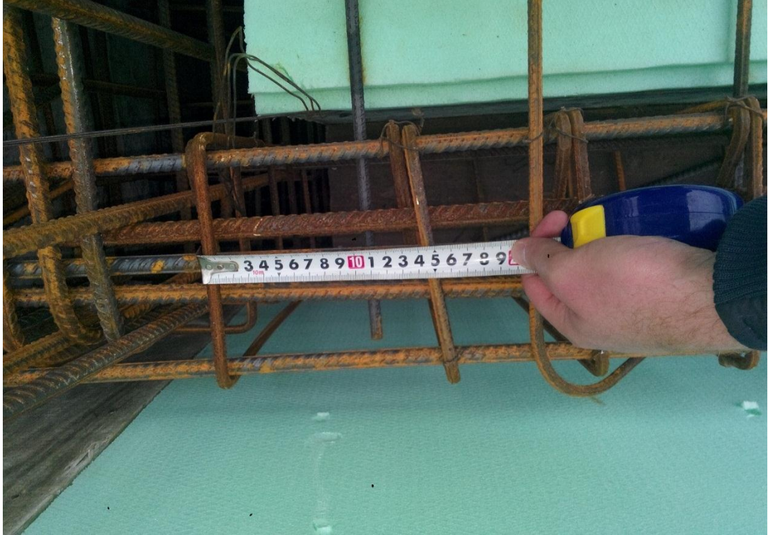
Şekil 4.18. Kiriş sarılma bölgelerinde enine donatı aralığı şartına uyulmaması durumu
