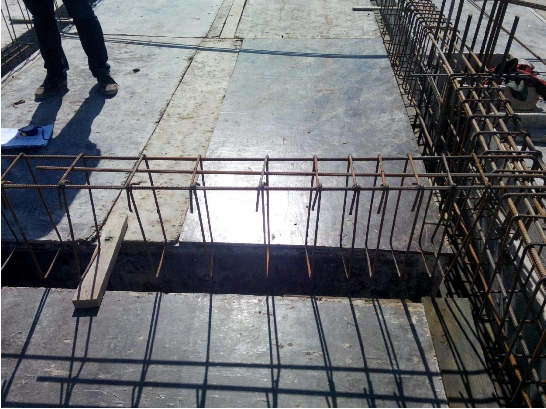
Şekil 4.19. Kiriş sarılma bölgesi uzunluğuna uyulmaması durumu
