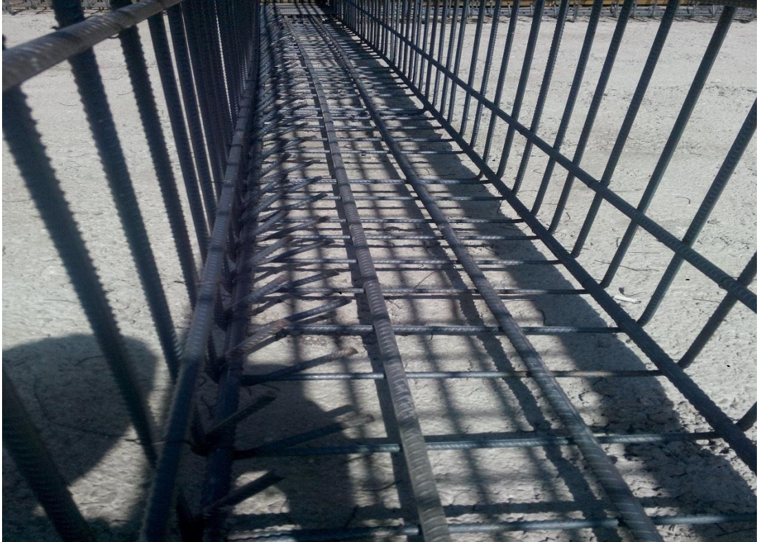
Şekil 4.5. Etriye kancalarının yönetmeliğe uygun 135 derece olması durumu
