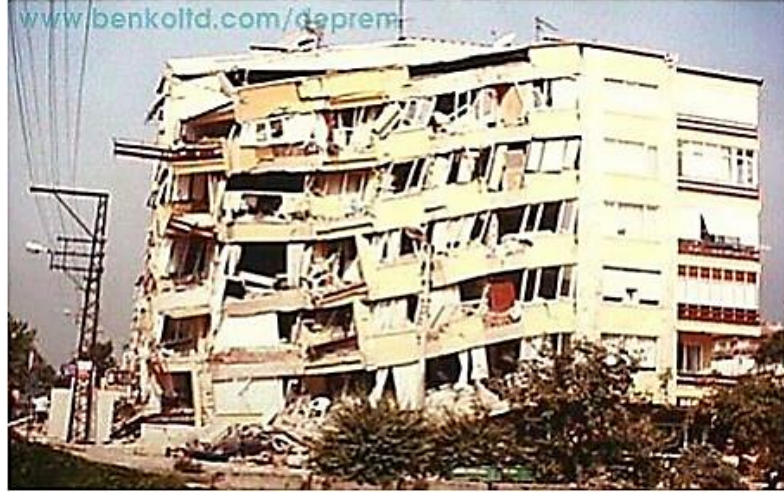
Şekil 3.5. Burulmadan dolayı bina köşelerinde ağır hasar, Yalova, 1999 (Kurt, C.)
