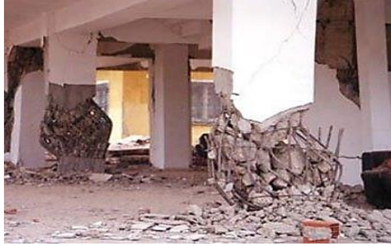
Őekil 3.3. Burulma etkisinde kolonlarda hasar durumu (Kurt, C.)
