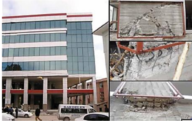
Őekil 3.4. 2011 Van Depremi, Burulma Hasarı (Grer, C.)
