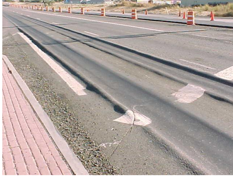
Şekil 2.7. Tekerlek izi oluşumu [1]
