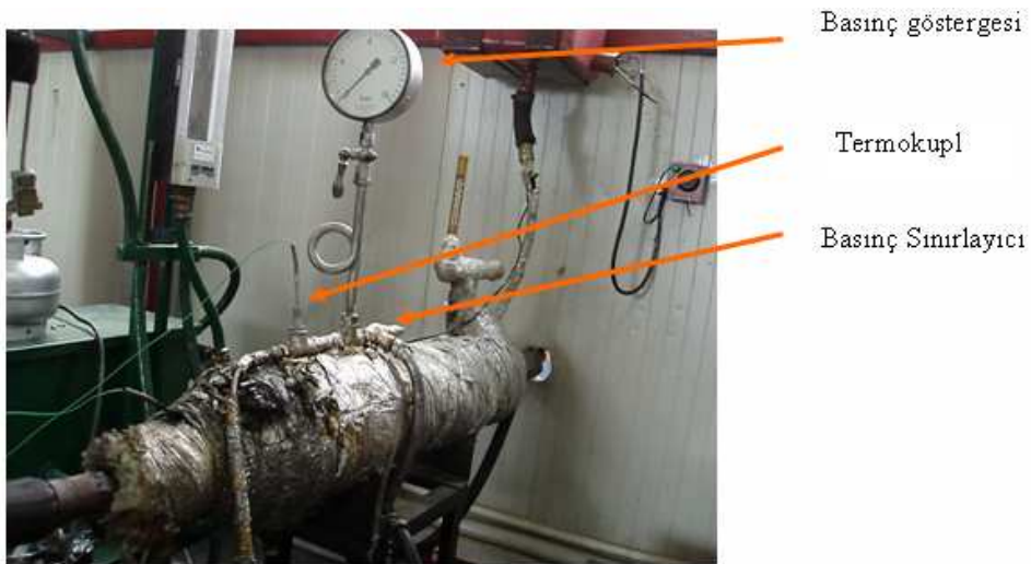
Şekil 4.29. Atık ısı kazanı ve üzerindeki ekipmanlar
