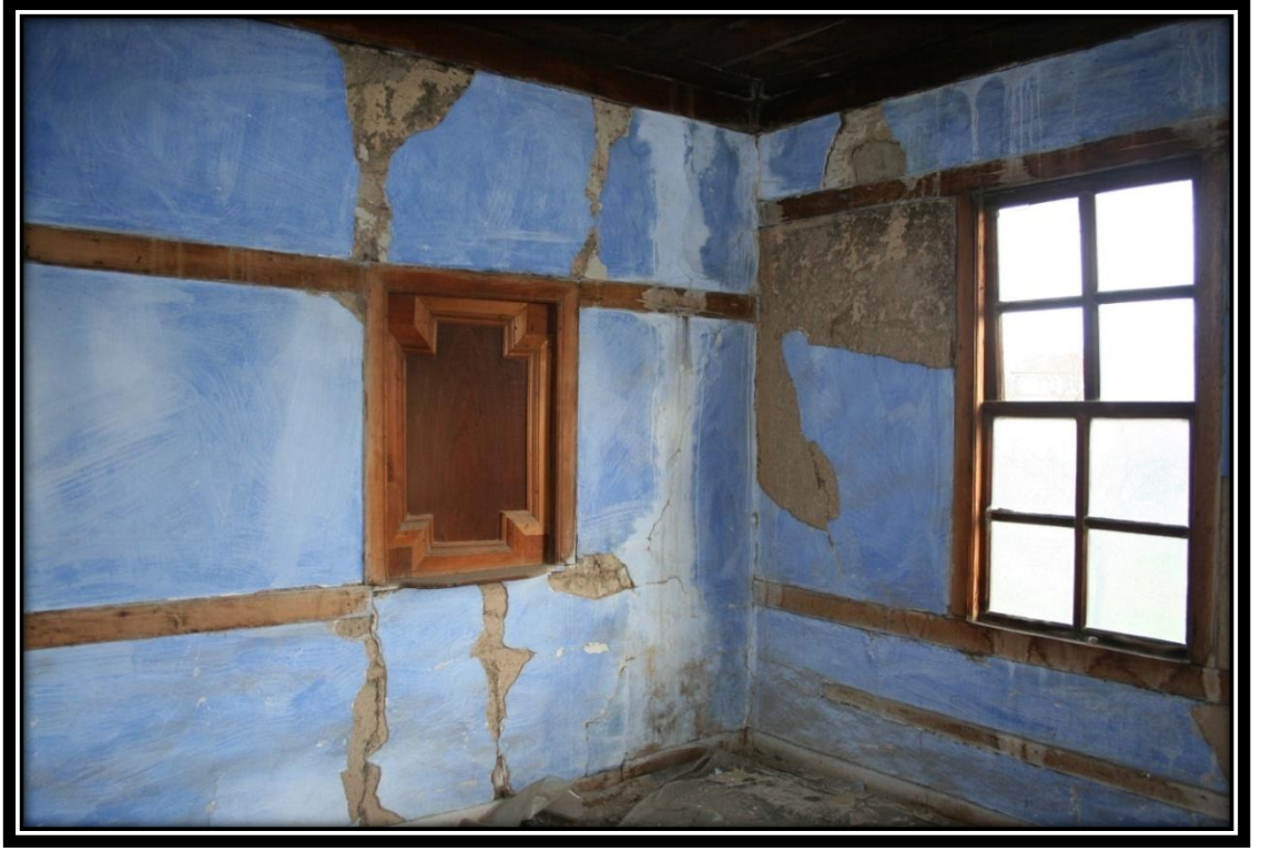
Resim 75: Mehmet Başel Evi; 2.Kat Doğu Cephe Odası Duvar Nişi
