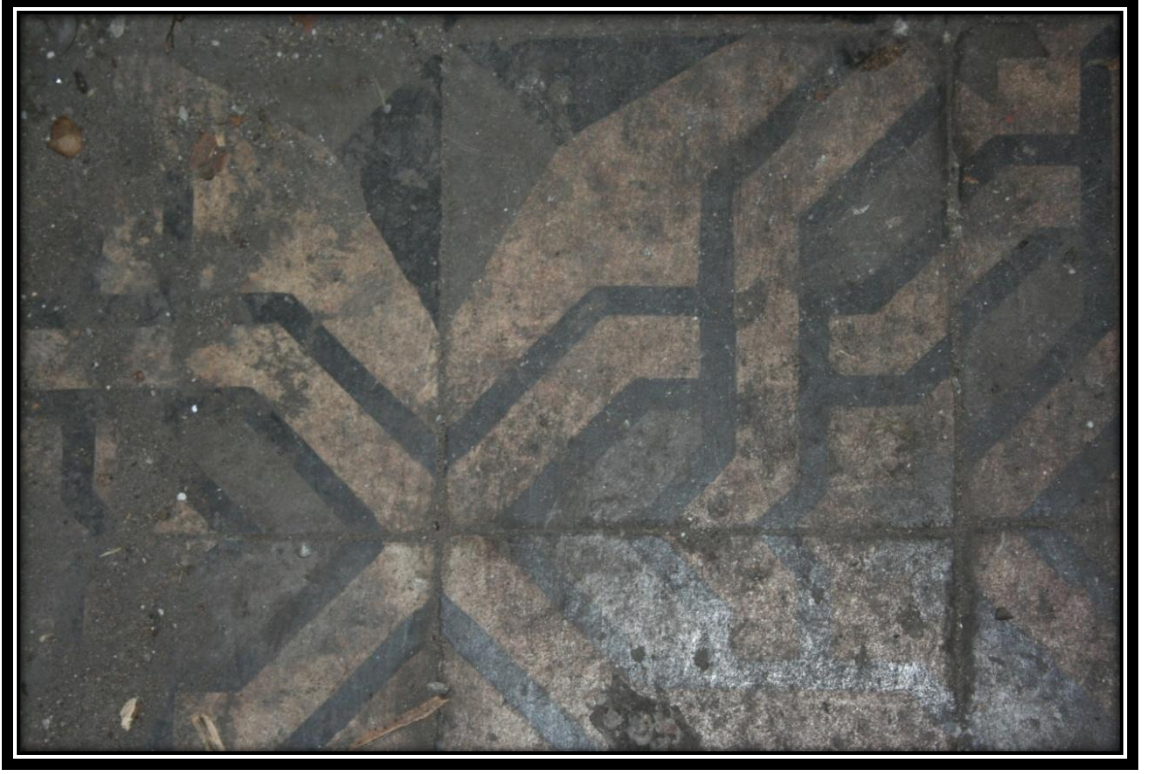
Resim 130: Sedat Tavşancı Evi; Zemin Kat Ve Doğu Cephesi Balkonu Yer Karasu
