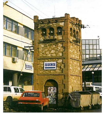
Prizren Elektrik Trafosu
