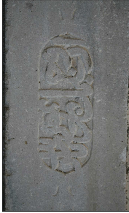
Fotoğraf 33: Tevfik Bey Çeşmesinin Ön Cephedeki Platerlerde ve Arka Cephedeki Alınlık Bölümünde Yer Alan Kitabeler (1)
