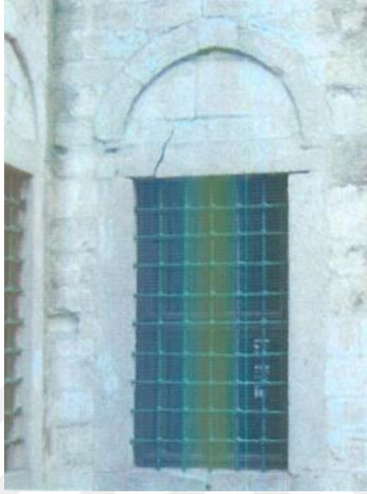
Pencere lentosundaki çatlaklar
