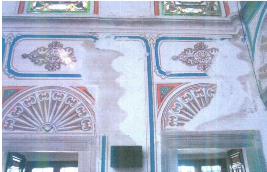
Harim kısmının duvar yüzeylerindeki bozulmalar
