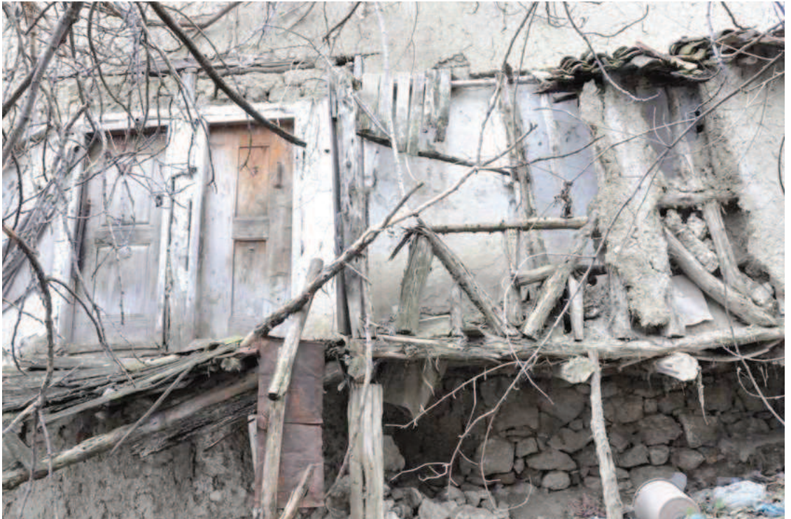
Osman Kayacık Evi güney cephesinde yıkılan müştemilat kısmı
