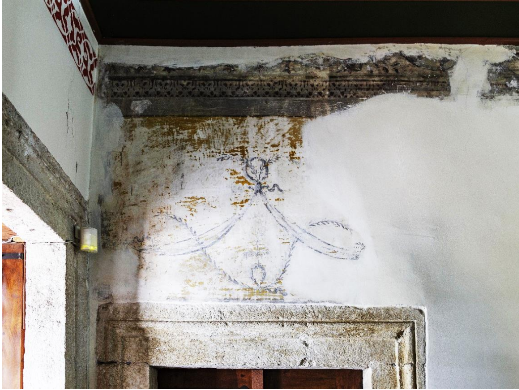
Fotoğraf 87: Takkeci İbrahim Ağa Camii Üst Kat Doğu Duvarında Yer Alan Duvar Resimleri
