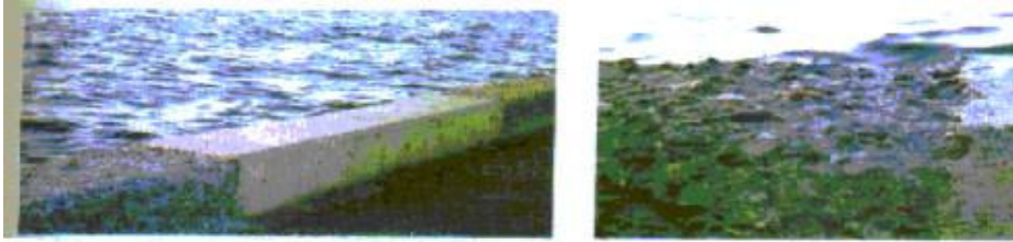
Şekil 3.6. Sahil yolunda (İzmir) deniz suyu etkisiyle iri agregaları açığa çıkmış, kütle kaybına uğramış beton parapet duvarı
