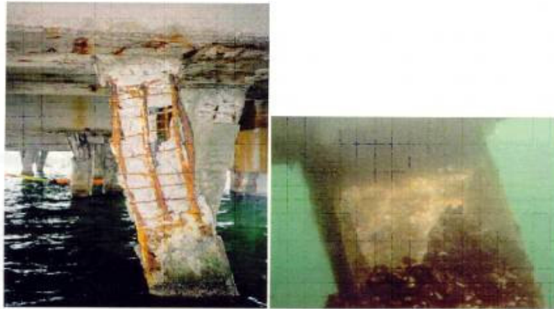
Şekil 3.9. Yarımcı Pektim iskelesinde 1999 Marmara depremi sonrası deniz suyu ve deprem hasarı, aynı yerde deniz altında kalan betonarme elemanlar
