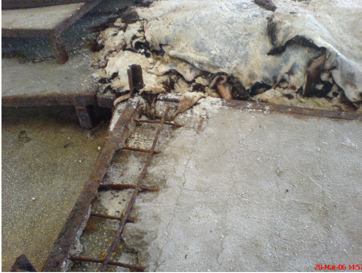
Şekil 3.11. Et Balık Kurumunda tuz etkisinde kalmış beton örneği
