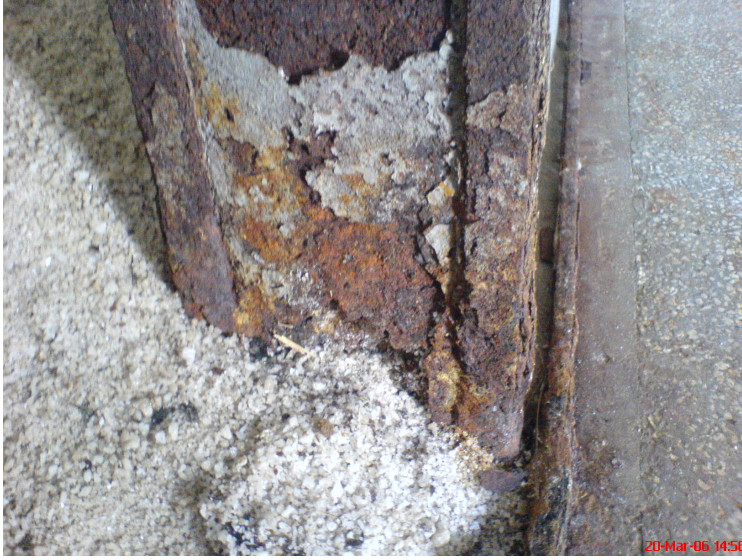
Şekil 3.10. Et Balık Kurumunda tuz etkisinde kalmış beton örneği
