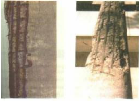
Şekil 3.7. İzmir’ de korozyon hasarına uğramış elektrik direkleri
