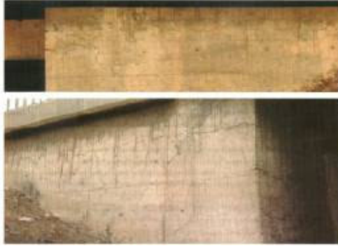
Şekil 3.8. ASR hasarına uğramış köprü ayakları (İzmir)
