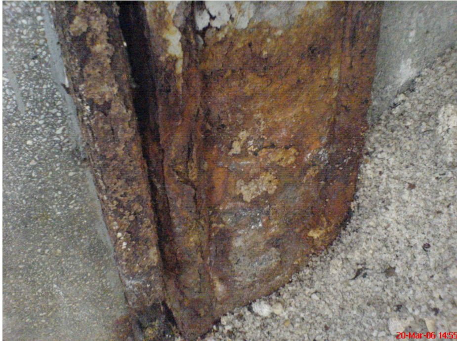
Şekil 4.8. Çelik profil kapı kasalarının tuza birebir maruz kalması durumu yakın görünüm
