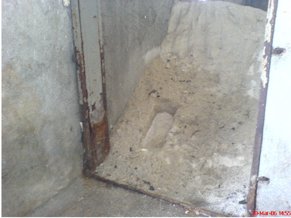
Şekil 4.7. Çelik profil kapı kasalarının tuza birebir maruz kalması durumu
