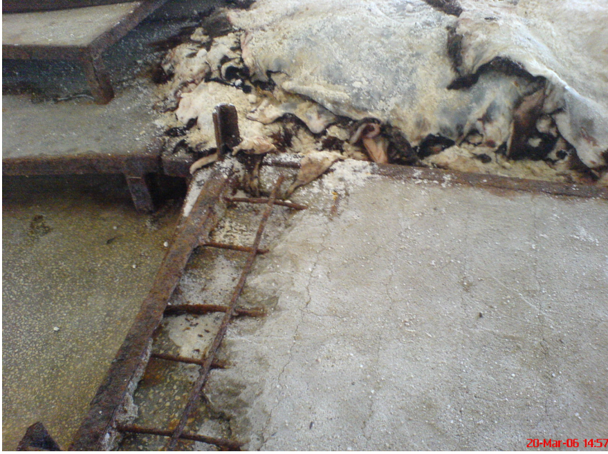
Şekil 4.5. Hayvan derilerinin tuzlanarak üstüne koyulduğu betonarme palet
