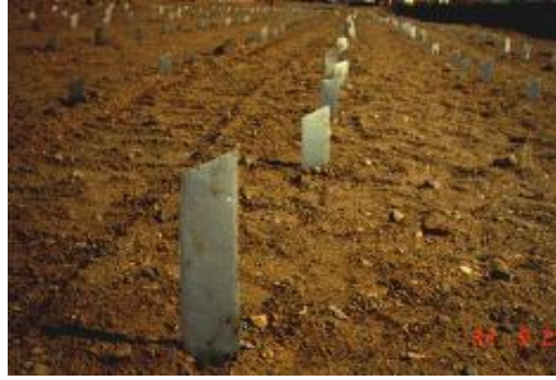
Resim 7.4. Düşey dren uygulanmasından sonra zemin suyu tahliyesi için bırakılan düşey dren kanal çıkışı
