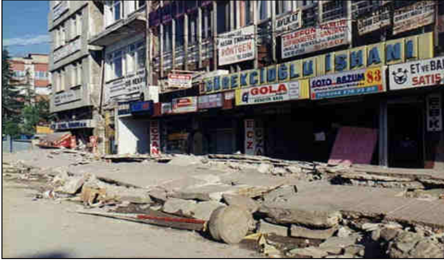
Resim 5.3. Adapazarı – Bulvar. Sıvılaşma nedeniyle yükselen kaldırım
