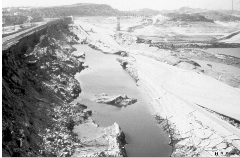
Şekil 5.9.Hidrolik dolgu ile inşa edilmiş barajın memba şevi sıvılaşma sonucu kaymış San Fernando Barajı California / ABD 1971
