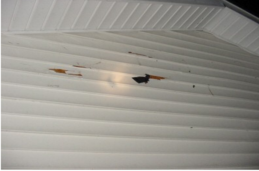
Şekil 4.13. Darbe sonucu hasar gören plastik kaplama örneği
