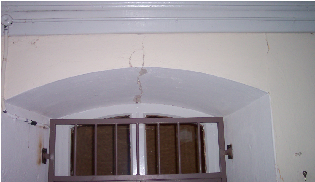
Şekil 4.19. 1999 Marmara depreminden kaynaklanan asma katta oluşan çatlaklar
