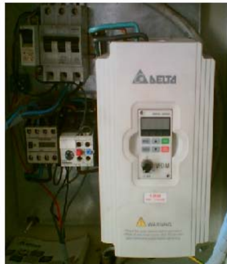
Şekil 6.6. Elektronik devir ayarlayıcı (inverter)
