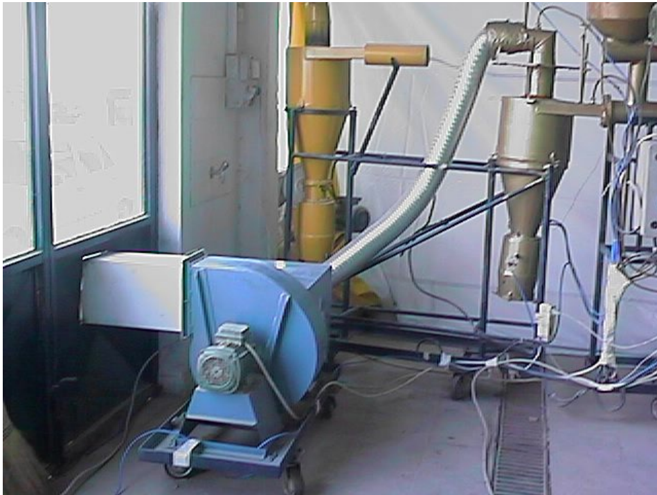
Şekil 3.1.17. Önısıtıcı Siklon ve Vantilatör Bağlantısı
