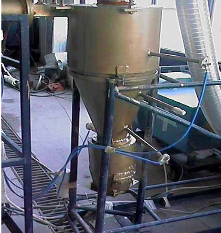
Şekil 3.1.19. Önisıtıcıya Bağlı Termokupllar
