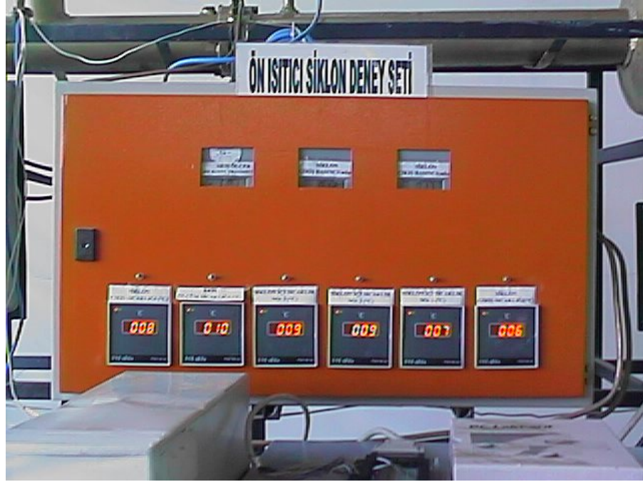
Şekil 3.10. Basınç transmitterlerinin ve sıcaklık göstergelerinin ön görünümü
