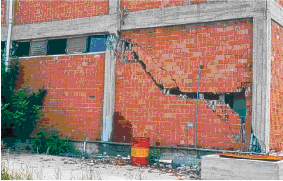
(a) Kısa Kolon Hasarı
