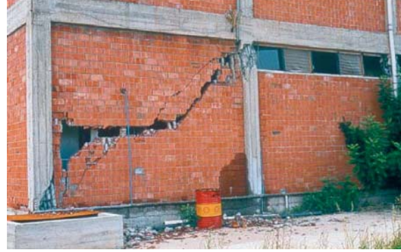
Şekil 4.6 Kısa Kolon Hasarı
