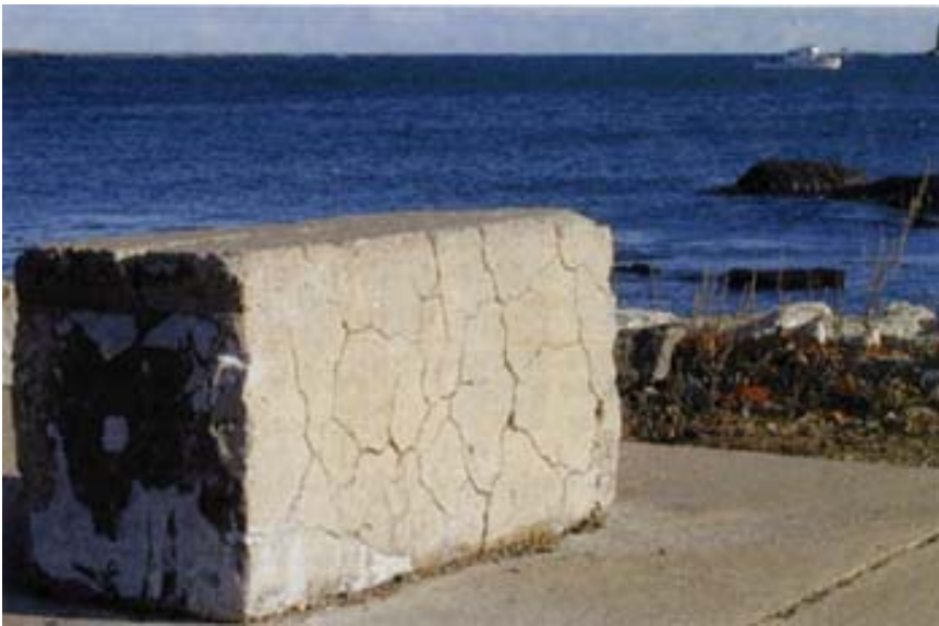
Betonda alkali agrega reaksiyonu ile oluřan harita atlakları
